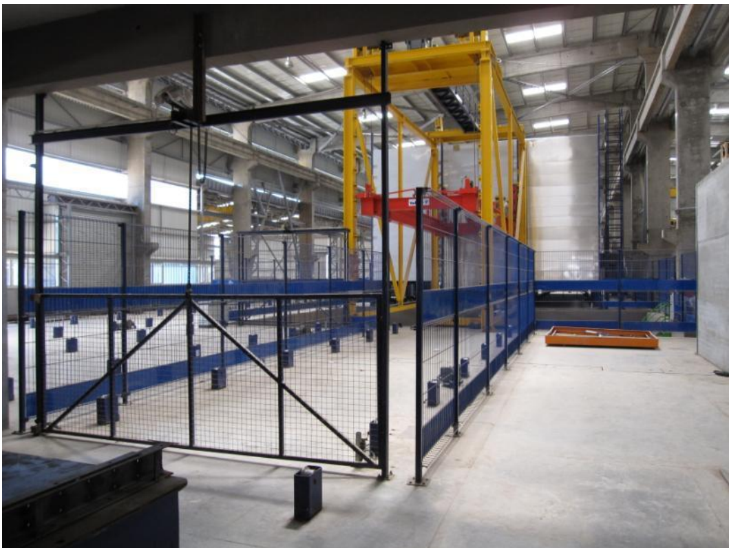
Abb. 14: Die Härtekammer besteht aus drei Regaltürmen mit jeweils 14 Palettenfächern übereinander
