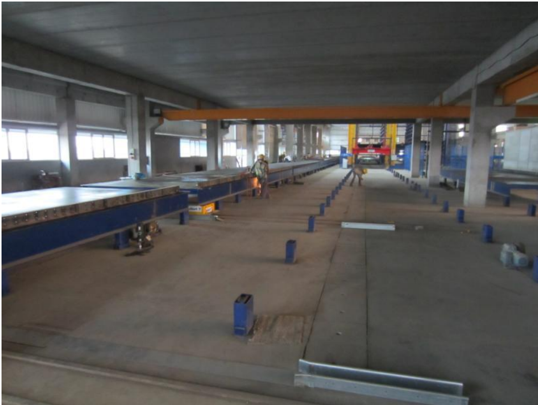
Abb. 11: Die Paletten fahren direkt unterhalb der Glättstation hindurch zur Härtekammer
