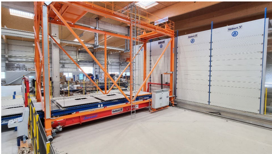
Bild 8: Für einen energieeffizienten Aushärtvorgang sorgt eine isolierte Vario CURE Härtekammer mit speziellem Wärmezirkulationssystem.
