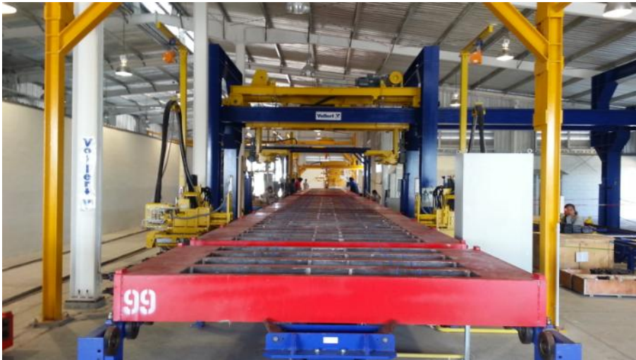
Abb. 9: Über eine teilautomatisierte Entspannungstation wird anschließend der Umspannprozess eingeleitet.
